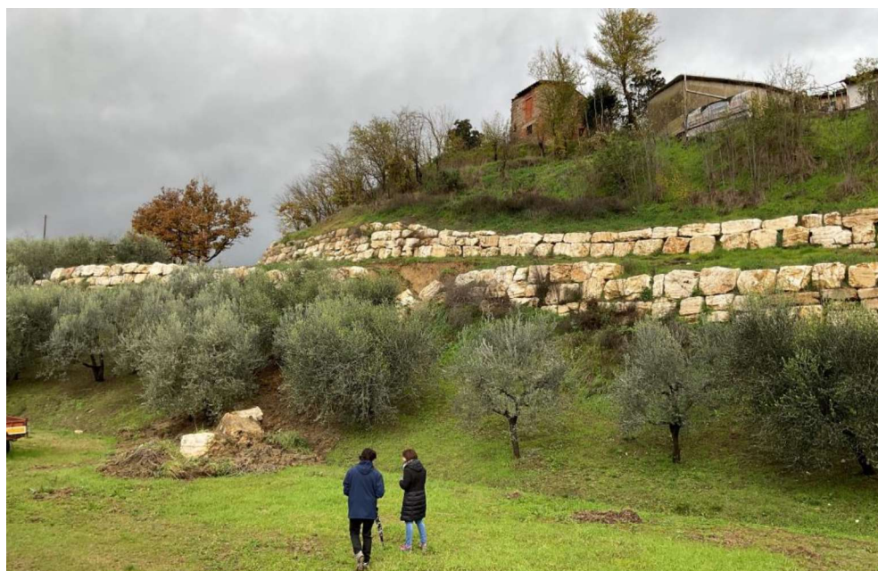
Figura 2 - Visione frontale della porzione del versante sud della collina di Ricasoli interessata dal movimento franoso. Si nota in primo piano l'accumulo della frana sul terreno agricolo sottostante.
