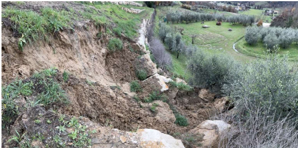
Figura 1 - Frana sul versante sud dell'abitato di Ricasoli, che ha coinvolto una porzione delle opere di sistemazione del versante.
